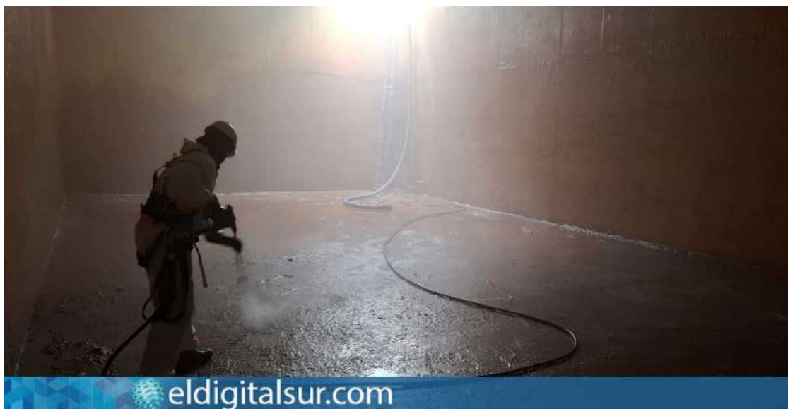
Depósito de agua potable de Caletillas / EDS
